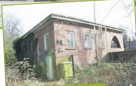
Hinter den Kulissen ist der schlechte Zustand des Gebäudes von 1927 unübersehbar
